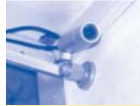
Les caméras situées dans le bâtiment communal
